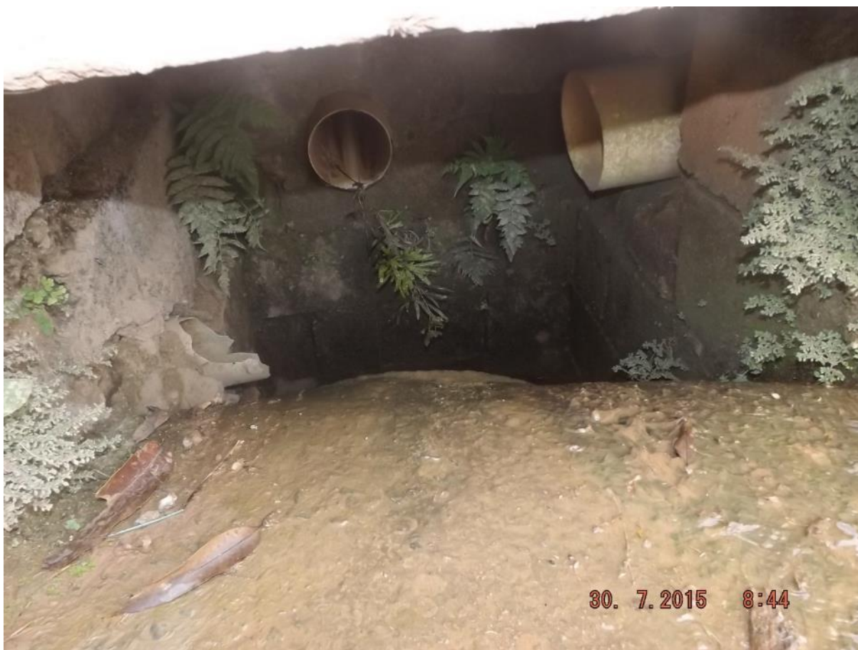
Figura 116 - Rede mista de esgoto e águas pluvias
