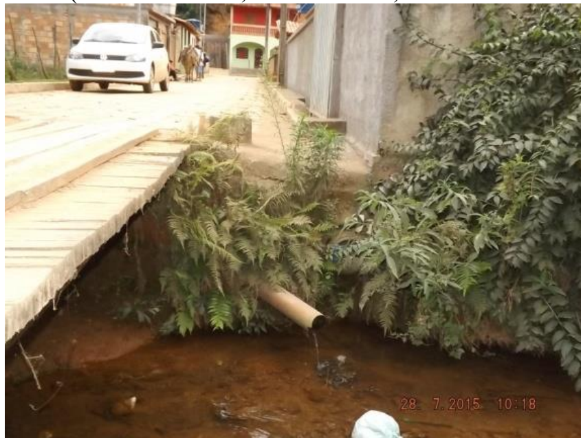
Figura 68: Lançamento de esgoto doméstico in natura na área urbana de Esmeraldas de Ferros (Local: S 19°19'54,42" W 42°52'39,66" /Altitude: 315m)
