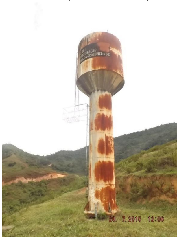
Figura 54: Reservação de distribuição: Capacidade de 50m 3 (Local: S 19° 17'21,66" W 42° 47'45,84"/Altitude: 576m)
