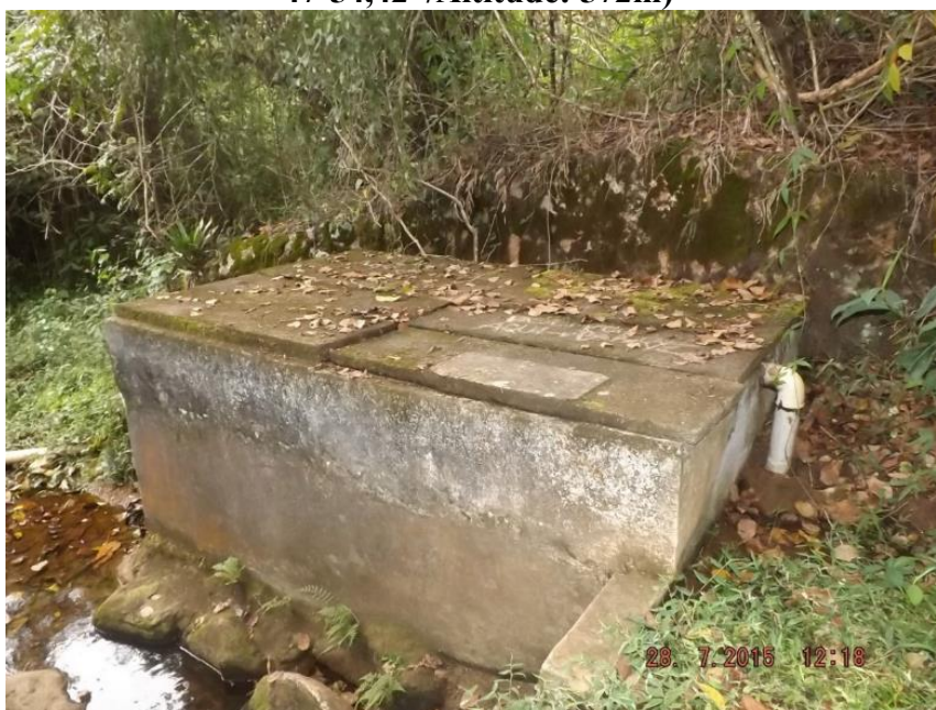
Figura 53: Reservatório Primário, Capacidade de 10m 3 (Local: S 19° 17'17,34" W 42° 47'54,42"/Altitude: 572m)
