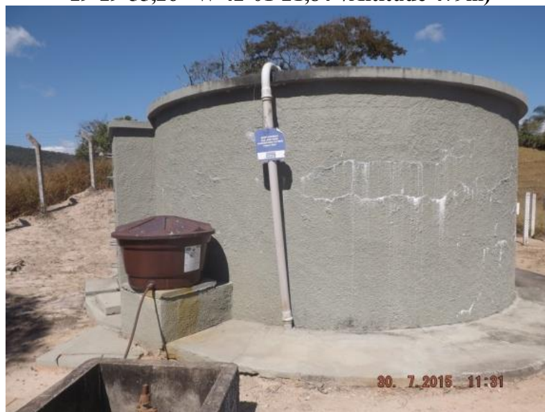
Figura 40: Reservatório Elevado para lavagens de filtros, Capacidade 55m 3 . Local: S 19°19'55,26" W 42°01'21,84"/Altitude 479m)
