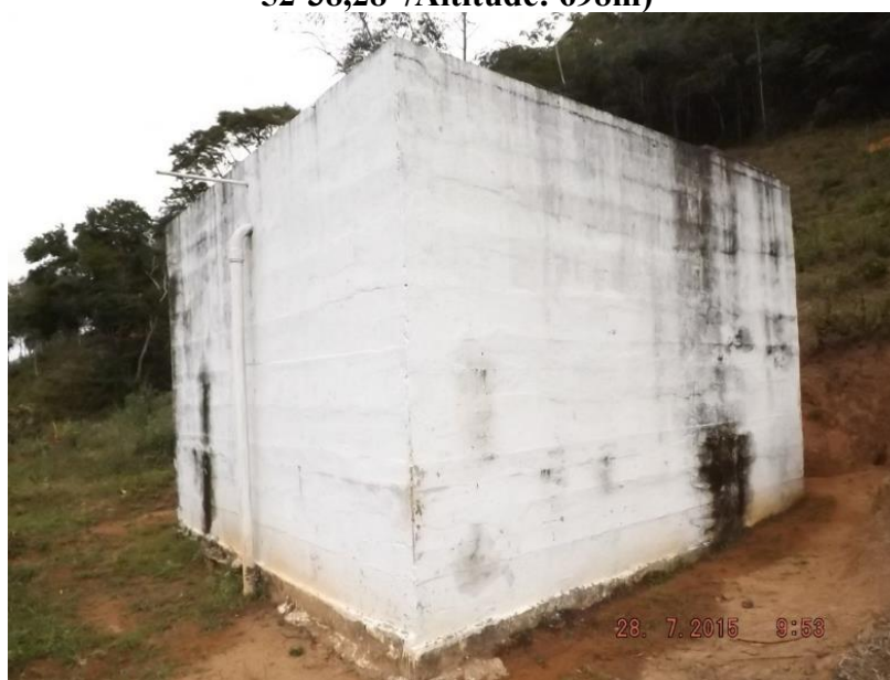
Figura 48: Reservatório de Esmeraldas de Ferros (Local: S 19° 19'46,98" W 42° 52'38,28"/Altitude: 698m)
