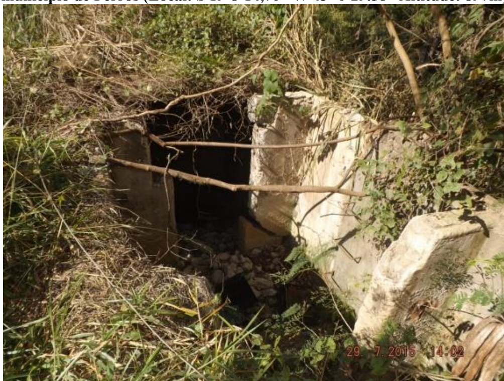
Figura 81: Fossa Negra comunitária desativada em Borba Gato, Zona Rural do município de Ferros (Local: S 19°8'14,70" W 43° 0'29.58" Altitude: 897m).
