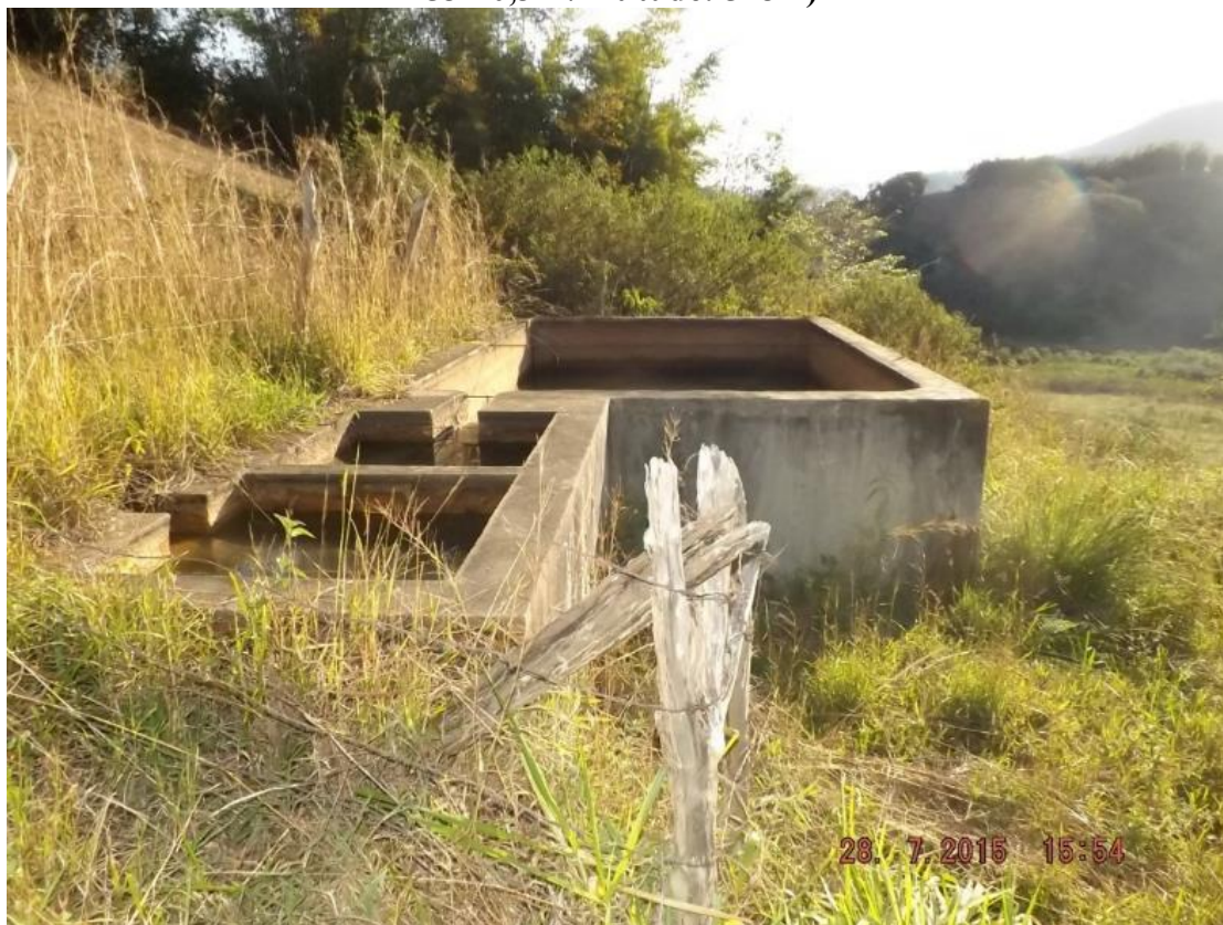
Figura 50: Captação e Reservação Secundária (Local: S 19° 09'46,08" W 42° 53'20,34"/Altitude: 548m)
