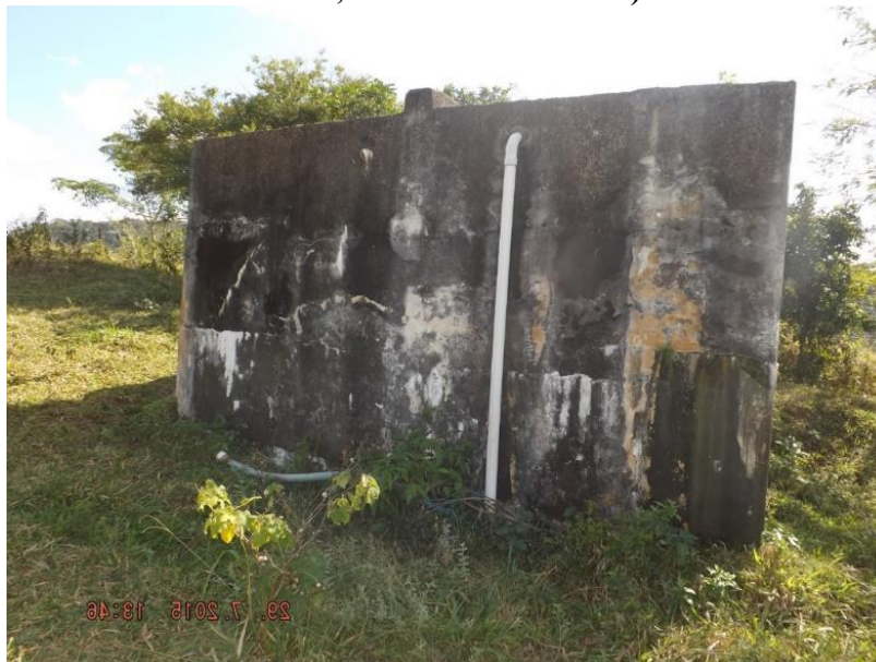
Figura 56: Reservação: Capacidade de 65m 3 (Local: S 19° 07'52,14" W 42° 59'57,78"/Altitude: 751m)
