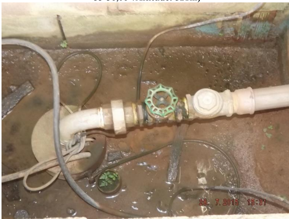
Figura 49: Captação Santo Antônio da Fortaleza (Local: S 19° 09’52,50” W 42° 53’36,06”/Altitude: 521m)
