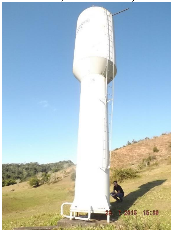
Figura 51: Reservação-Capacidade 35m 3 (Local: S 19° 09'52,44" W 42° 53'36,06"/Altitude: 521m)
