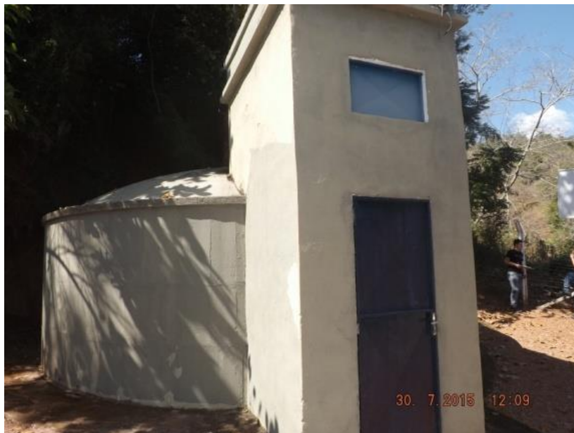
Figura 42: Reservatório Apoiado 02- Capacidade 55m 3 . Local: S 19°13'50,22" W 43°01'06,84"/Altitude 442m)
