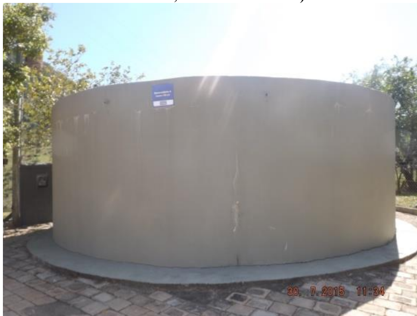
Figura 44: Reservatório Apoiado 04, Capacidade 150m 3 . Local: S 19°15'06,60" W 43°00'50,70"/Altitude 474m).
