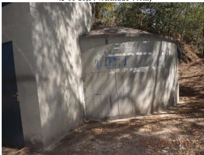
Figura 41: Reservatório Apoiado 01 - Capacidade 55m 3 . Local: S 19°13'55,26" W 43°01'21,84"/Altitude 440m)
