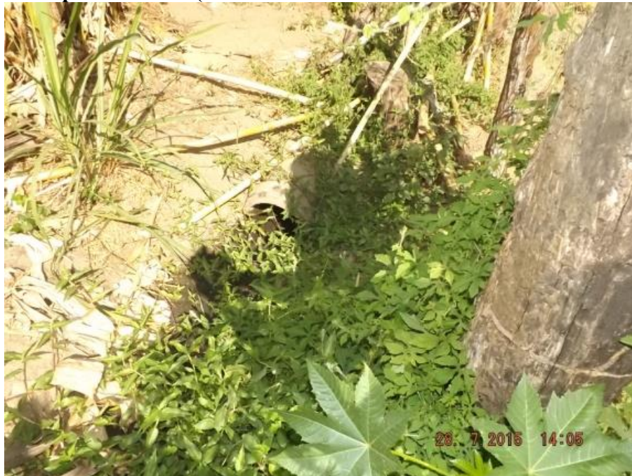
Figura 87: Lançamento de esgoto doméstico a céu aberto em Sete Cachoeiras, Zona Rural no município de Ferros (Local: S 19° 11'56.16" W 42° 53'59,76"/ Altitude: 897m)
