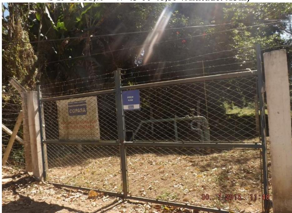
Figura 32: Local de Captação da água bruta no Poço Artesiano C-04 (Local: S 19°14'51,79" W-43°00'48,80"/Altitude:413m)
