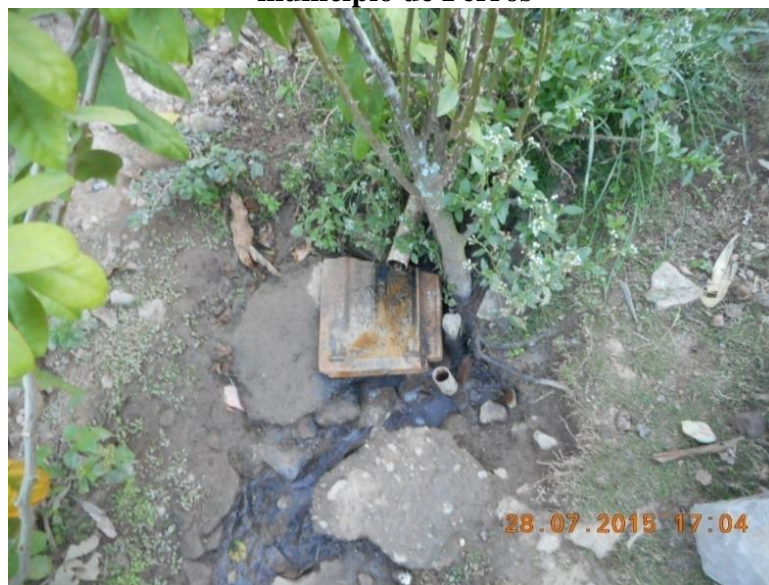
Figura 61: Ponto de lançamento de esgoto doméstico in natura , localizado na sede do município de Ferros
