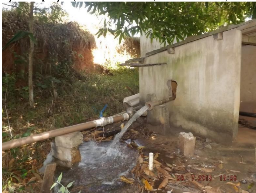
Figura 55: Poço de captação (Local: S 19° 07'58,74" W 43° 00'04,32"/Altitude: 701m)
